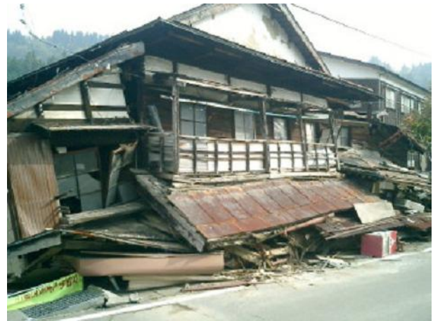
新潟県中越地震による木造家屋の倒壊
